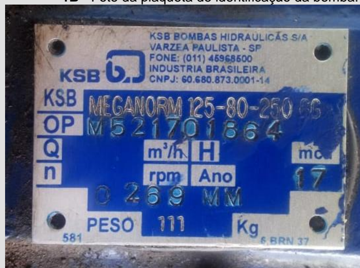
1B - Foto da plaqueta de identificação da bomba:
